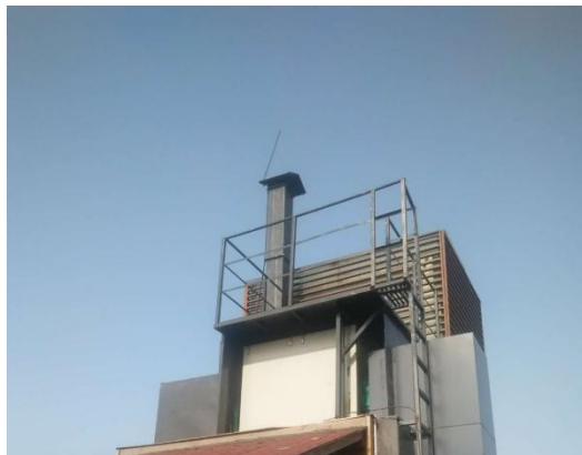
图 4-3 本项目废气处理设施现场照片
