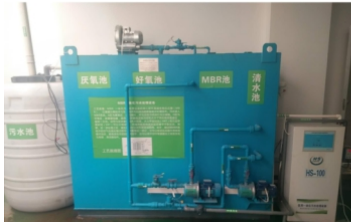
图 4-2 本项目水处理设施现场照片
